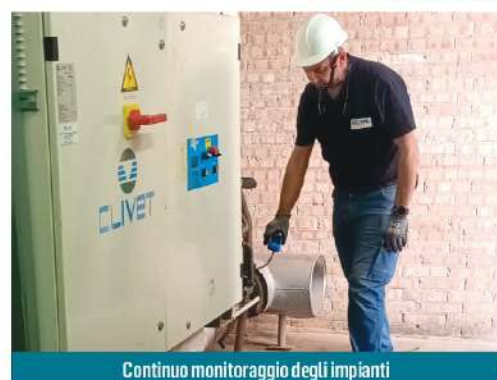
Continuo monitoraggio degli impianti
